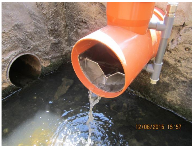
Фиг. 7.4 Хидрометрично съоръжение за отпадъчните води на изхода на ПСОВ ВРЗ гр.Септември
