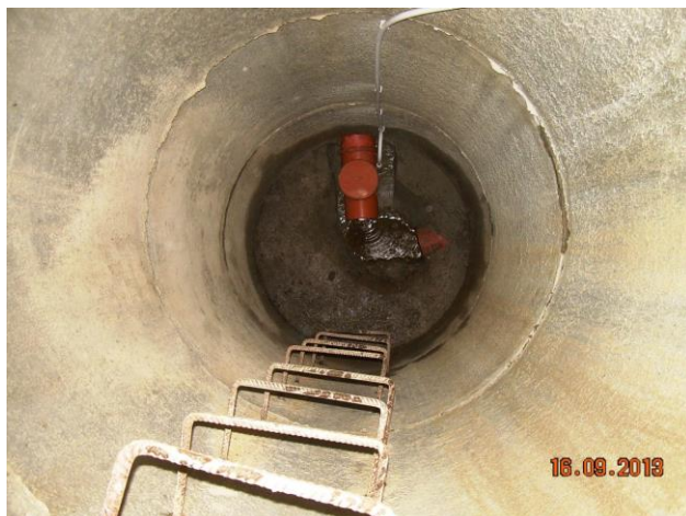
Фиг.7.1 Хидрометрично съоръжение тип Ф160 в ревизионната шахта на завод „Маршал.91“ ЕОД, с. Багреници.
